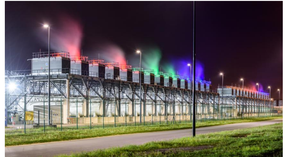
Refroidissement data center Google Saint-Ghislain (source: Le Soir) https://www.lesoir.be/527232/article/2023-07-24/le-data-center-belge-de-google-consomme-un-million-de-m3-deau-par
